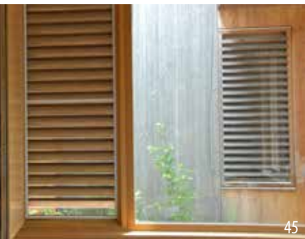
Nachtluftklappe im Schulgebäude
