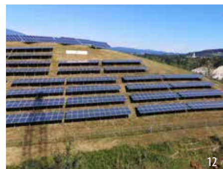
Doppelnutzung von Flächen: Deponie dient der Energiegewinnung
