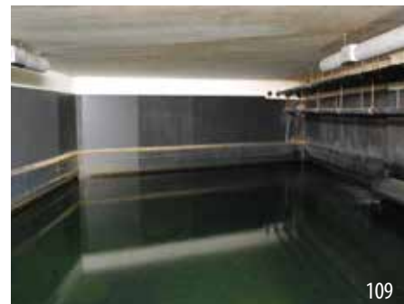
Technische Anlagen zur Regenwasserbewirtschaftung
